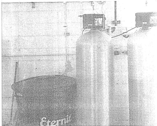
Foto 3. Filtros de gravilla y sistema de bombeo de resina para el manejo de las incrustaciones al interior de las calderas.
